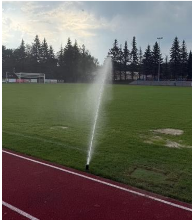
Instalacja nawadniająca na boisku sportowym w Makowie Podhalańskim. Źródło: Urząd Miejski w Makowie Podhalańskim.
