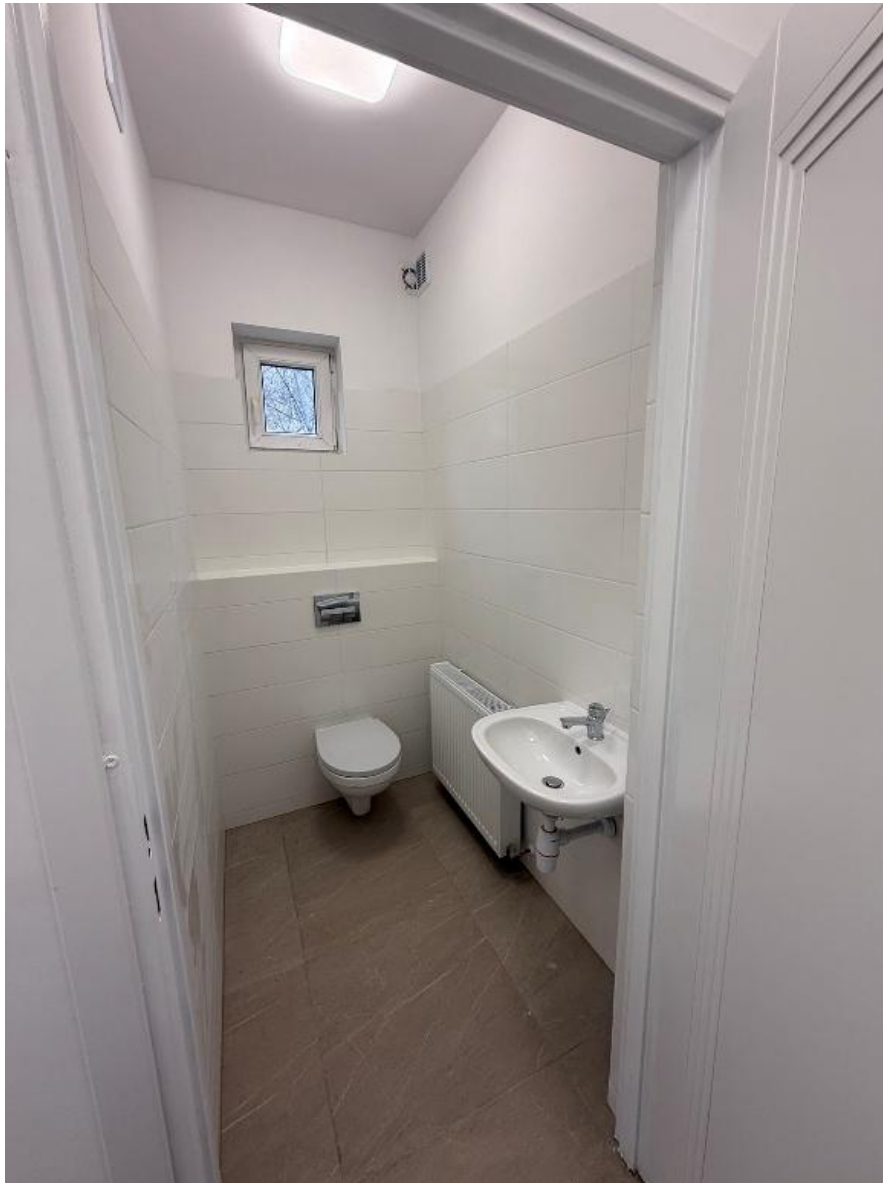
Światlica wiejska w Grzechyni, po remoncie. Źródło: Urząd Miejski w Makowie Podhalańskim.
